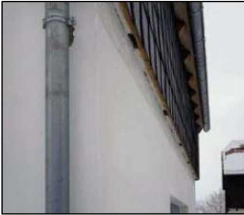
Abb. 31: Spaltenquartiere hinter Schieferverkleidung 4
