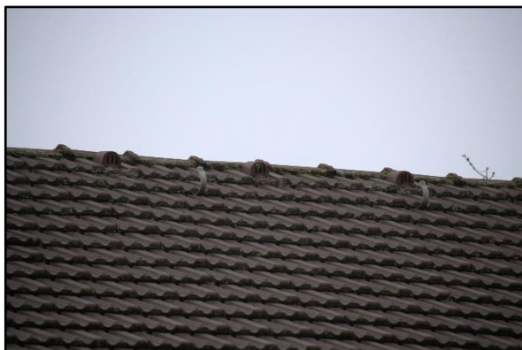
Abb. 25: Lüftungsziegel des Mehrfamilienhauses
