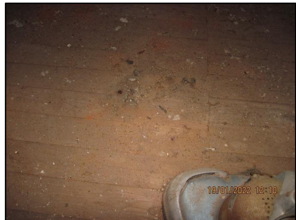
Abb. 18: Marderkot im Dachstuhl des Garagengebäudes
